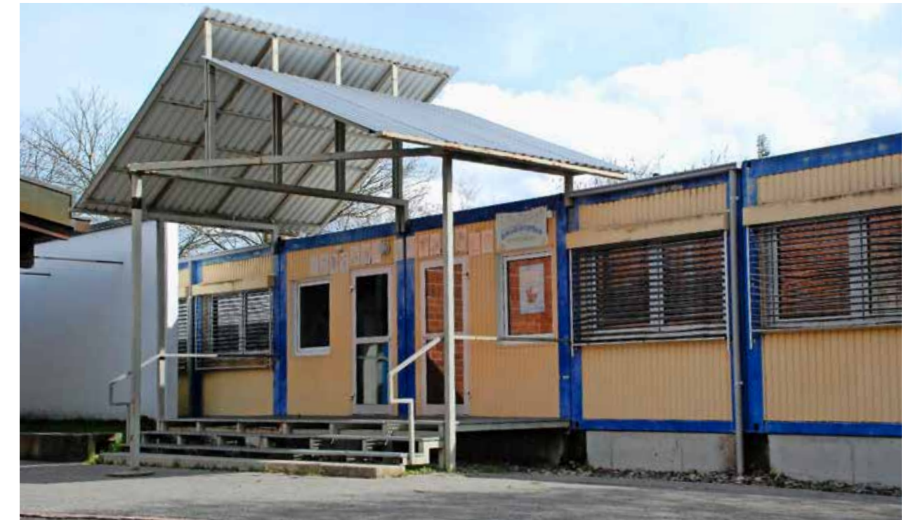
Die zwei Schulcontainer, die seit 1997 beim Schulhaus Breite stehen, sind heute in schlechtem Zustand.
